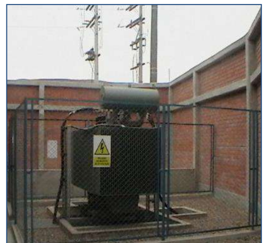
Transformador de Potencia
