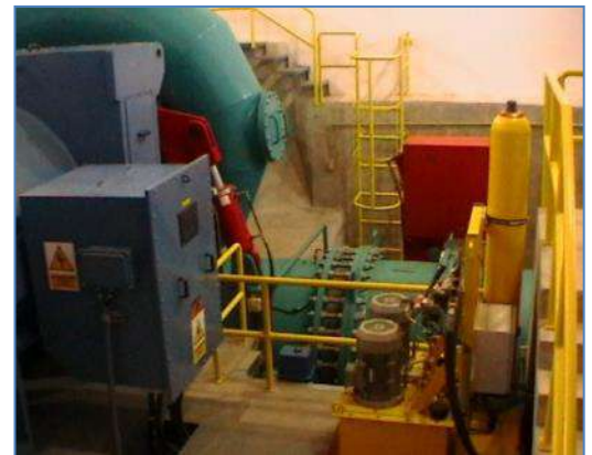
Turbina y Generador
