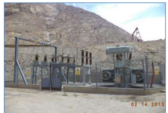
Subestación Eléctrica de la C.H. Yanapampa
