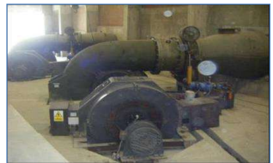
Turbina y Generador del Grupo 3
