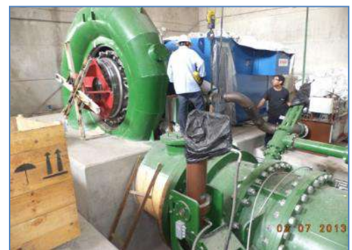
Turbina Rodete N° 2
