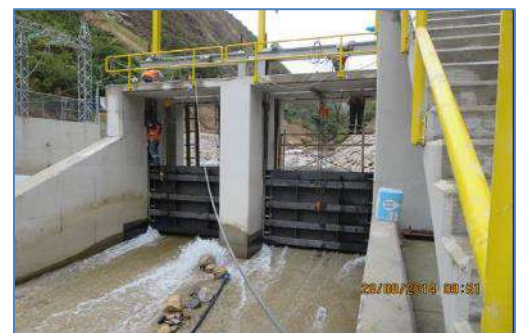
Compuertas del barraje móvil
