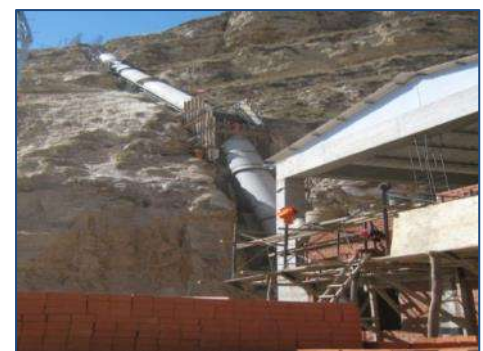
Vista de la Tubería Forzada-Casa de Máquinas
