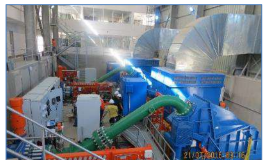
Casa de Máquinas
