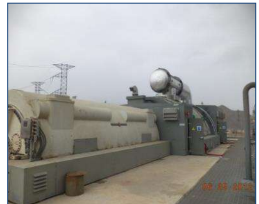
Turbina de Vapor
