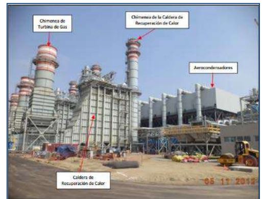
Vista de las Chimeneas de Turbinas de Gas, Calderas de Recuperación de Calor y Aerocondensadores
