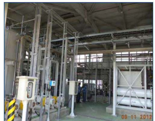
Vista de la Planta de Tratamiento de Agua.
