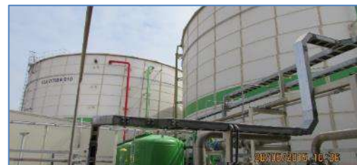
Tanques de almacenamiento de agua
