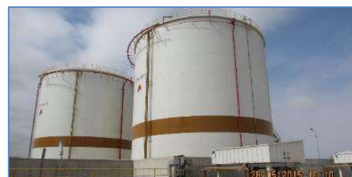
Tanques de combustible Diesel B5
