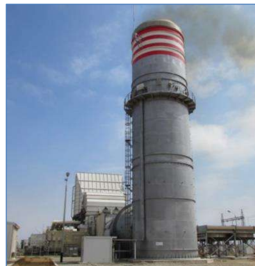
Unidad de generación turbina a gas
