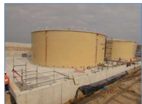
Tanques de almacenamiento de combustible Diésel B5
