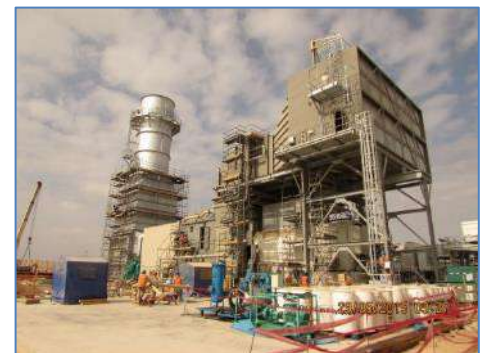
Turbogenerador y equipos auxiliares
