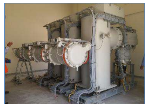
Subestación GIS en 60 kV
