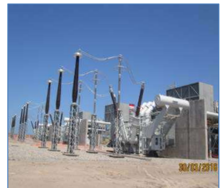
Transformadores de la C.T. Puerto Bravo
