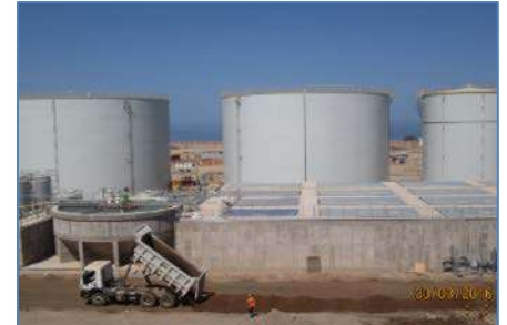
Tanque de Almacenamiento Combustible Diésel B5
