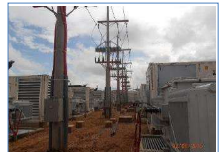
Sistema de Barras en 22,9 kV
