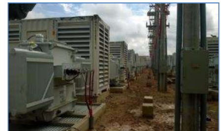
Grupos Electrógenos CAT Instalados (25 de 1,825 MW)
