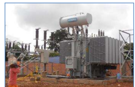
Transformador de Potencia de 50 MVA (22,9/60 kV)
