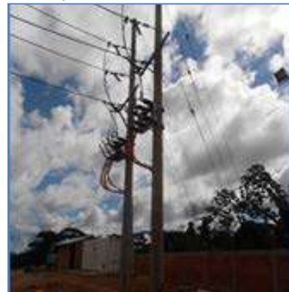
Conexión hasta la celda de ingreso en la S.E. Puerto Maldonado de Electro Sur Este.
