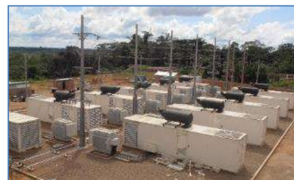
Grupos de generación y sistema de barras en 10 kV
