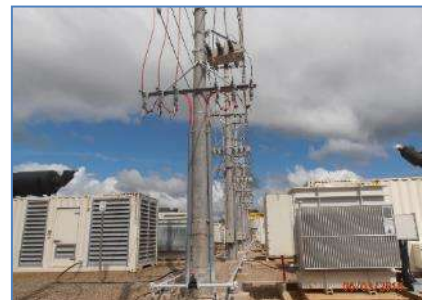
Transformador de distribución y sistema de barras
