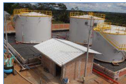
Tanques de almacenamiento de combustible
