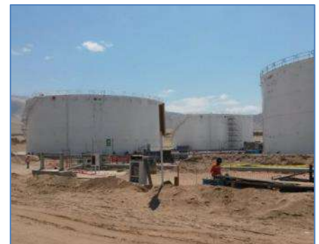
Tanques de almacenamiento de Combustible
