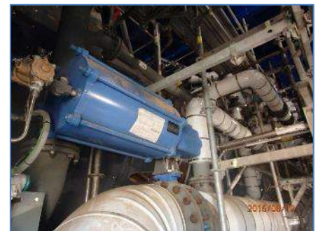
Instalaciones del Grupo N° 1
