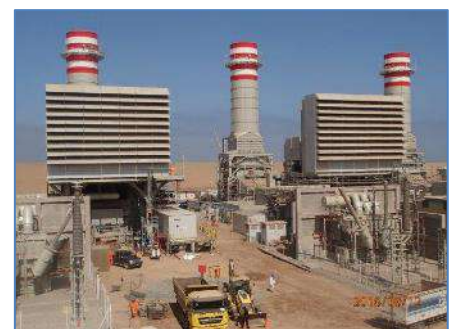
Vista de los turbogeneradores
