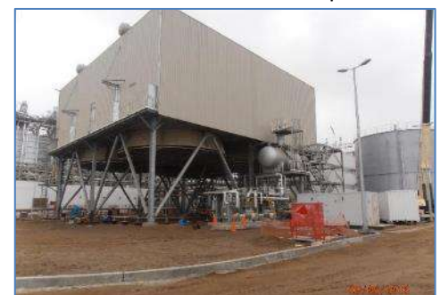
Vista del Aerocondensador
