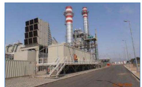
Chimeneas de los Ciclos Simple y Combinado
