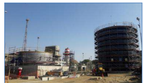
Tanque de transferencia de Diesel B5
