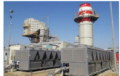
Chillers del Sistema de Enfriamiento
