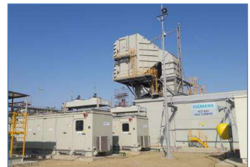
TG6 (Turbina – Generador Siemens)
