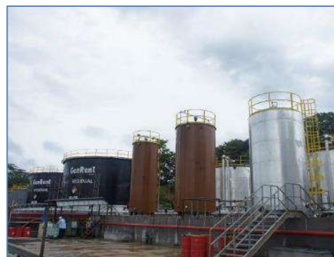
Tanques de combustible, aceite y agua
