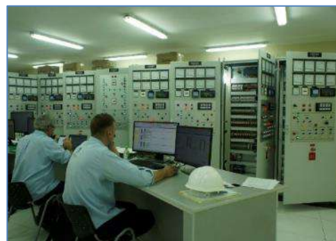
Sala de control de la C.T. Iquitos durante la energización de la L.T. 60 kV C.T. Iquitos – Iquitos existente
