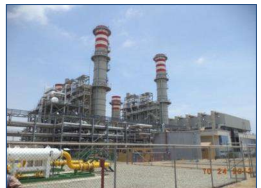
Calderos Recuperadores de Calor y Chimeneas Principales (Unidades 1 y 2)
