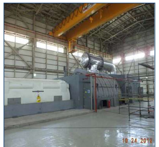
Unidad de Generación (Turbina a vapor)
