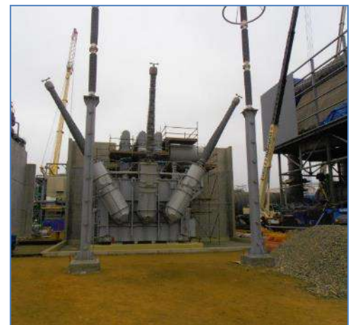
Transformador de potencia
