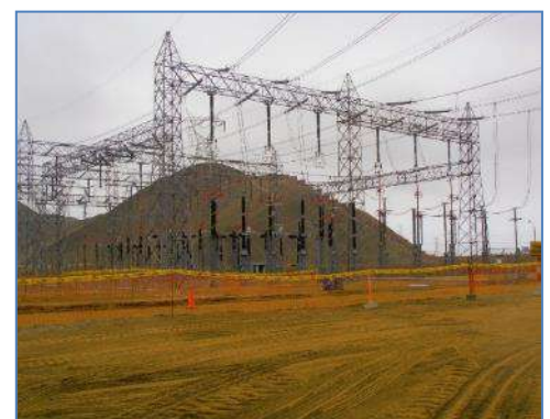
Patio de llaves en 500 kV
