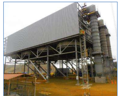
Vista general del Aerocondensador
