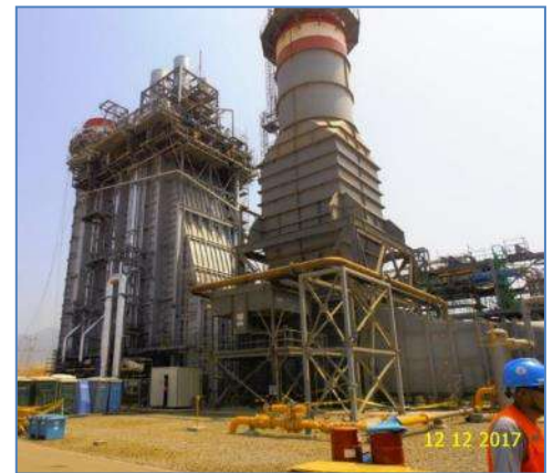
Caldera de Recuperación de Calor y Chimenea
