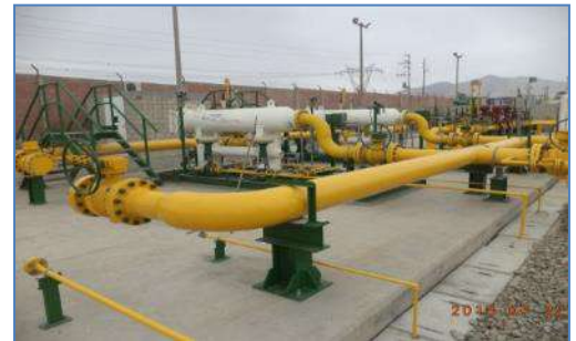
Acondicionamiento del Gas Natural para el ingreso a la Central
