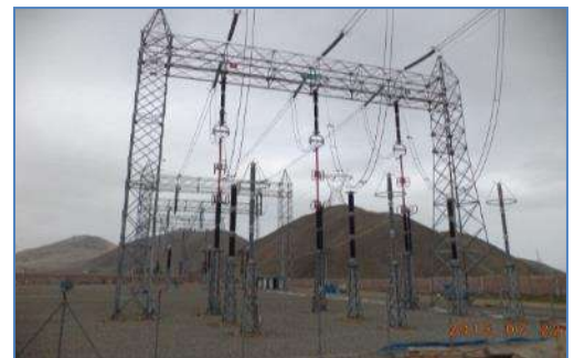
Patio de llaves - Central Santo Domingo de Olleros
