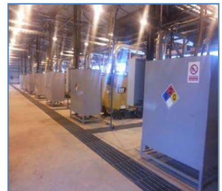
Vista de los 7 grupos electrógenos Diésel
