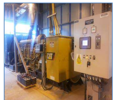
Generador Diésel N° 1
