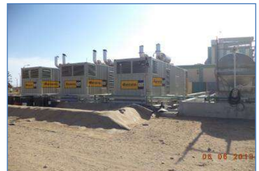
Sistema de Arranque Black Start (3x2,5 MW)
