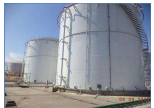
Tanques de almacenamiento de Combustible tratado B5 (2x3 000 m 3 )
