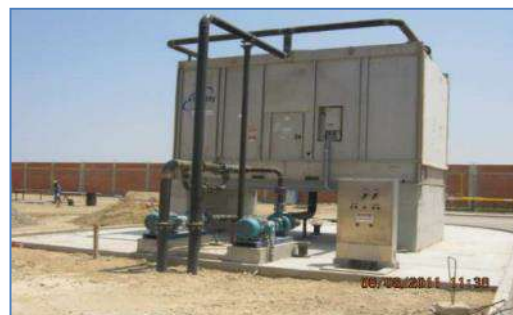
Torre de Enfriamiento de la Planta
