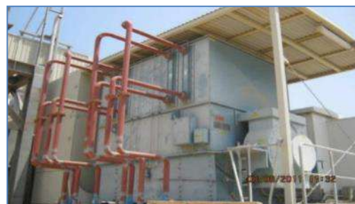
Generador Eléctrico ABB de 30 MW
