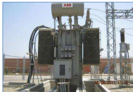
Transformador ABB de 42 MVA 60/13,8 kV
