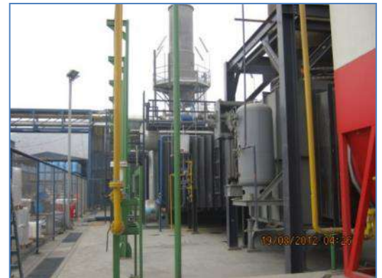
Instalaciones de C.T. Huachipa
