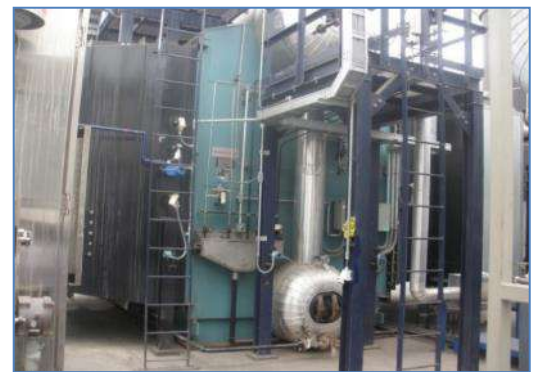
Caldera de Recuperación de calor
