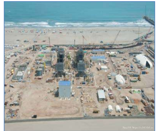
Vista de Frente de la Central
