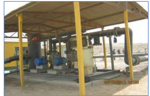
Planta de tratamiento de Biogás
