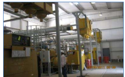
Grupos de Generación 3 x 1,6 MW
