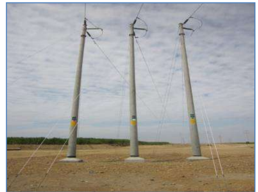
L.T. 60 kV S.E. Piura Oeste (SEPO)-S.E. Planta Etanol (SEPE)
