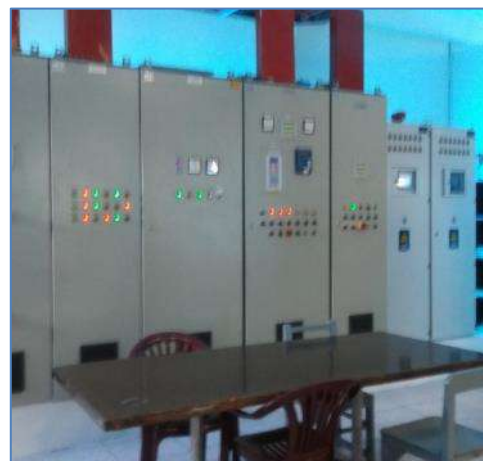
Sala de Tableros de Control y Mando
