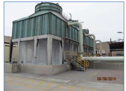
Radiadores del sistema de refrigeración de TV1
