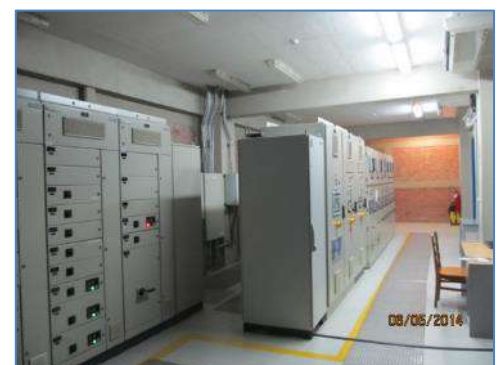
Sala de Tableros de Control de la unidad TV1
