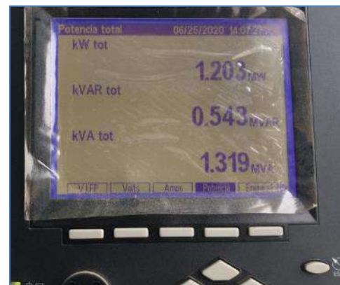
Panel de control del Grupo N° 1
