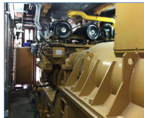
Vista del grupo de generación
