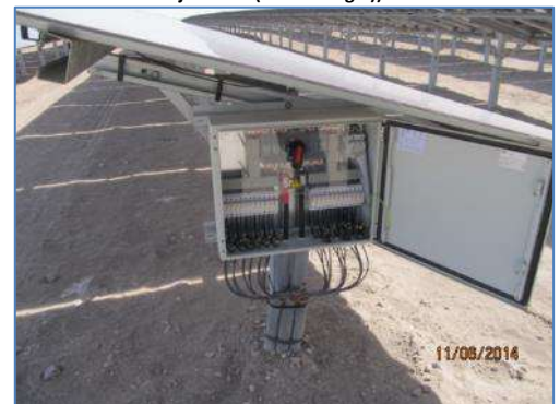
Caja de nivel 1
