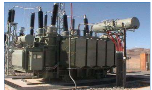
Transformador de Potencia 20 MVA, 23/138 kV
