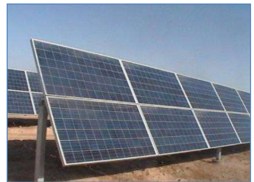
Módulos Solares Instalados
