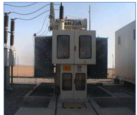
Transformador de Potencia de 20 MW – 23 7 66 kV (S.E. C.S Tacna)
