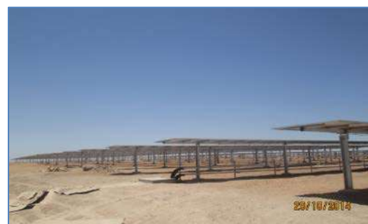
Módulos fotovoltaicos instalados
