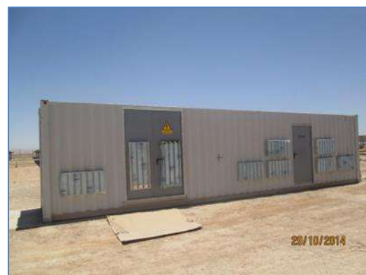
Caseta de transformador e inversores
