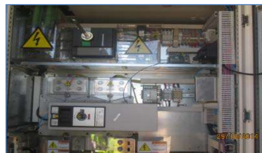
Vista del conexionado del inversor
