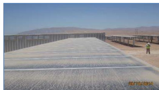
Vista de los módulos instalados
