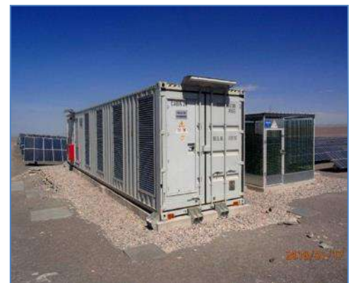
Caseta de inversores y transformadores
