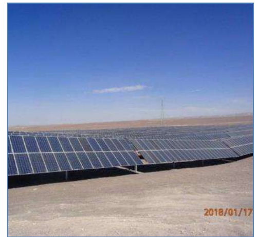
Vista de los paneles solares
