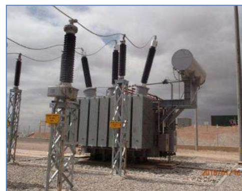
Transformador de potencia de 50 MVA
