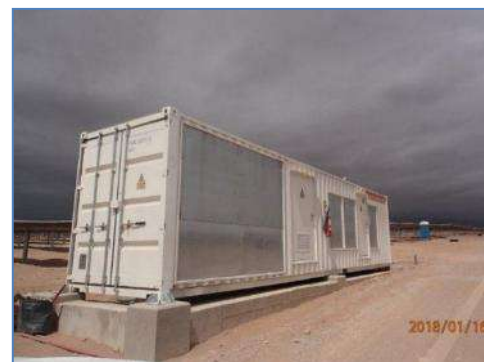
Caseta de inversores
