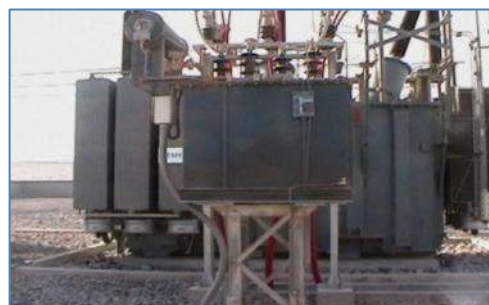
Transformador de 35 MVA – 220 kV
