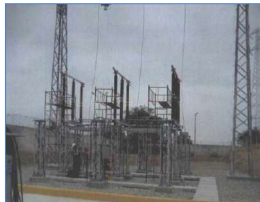
Pruebas Eléctricas al seccionador de Línea
