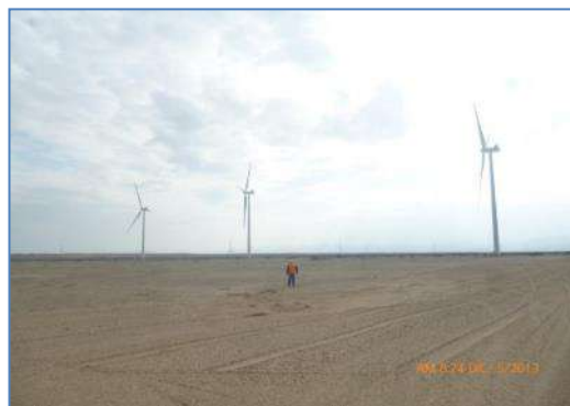
Vista de los aerogeneradores montados
