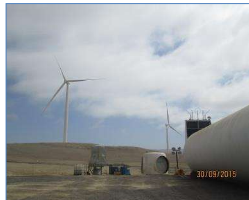
Vista de Aerogeneradores Instalados
