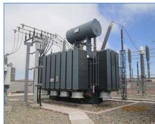
Transformador de Potencia 100 MVA
