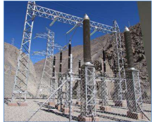
Patio de llaves S.E. Cheves
