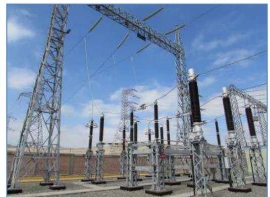
Celda de llegada en S.E. Huacho
