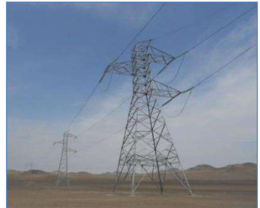
L.T. 220 KV S.E. Cheves-S.E. Huacho
