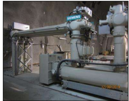
Subestación sistema GIS, en caverna
