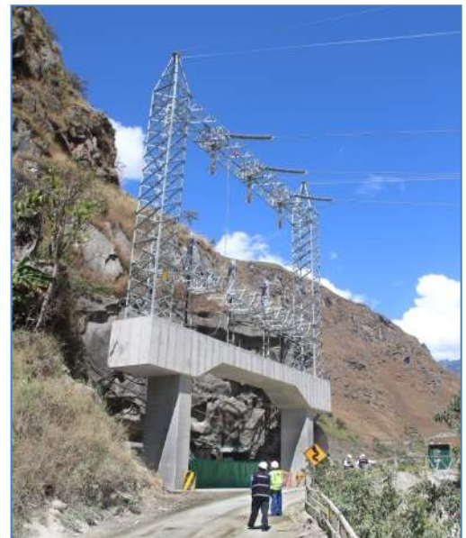
Pórtico 220 kV L-20149 Santa Teresa-Suriray
