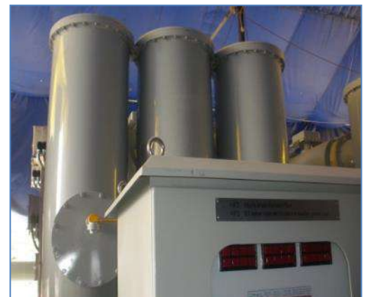
Equipamiento de la S.E. GIS Huanza
