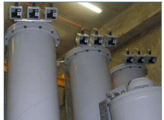
Circuitos de Salida en 138 kV
