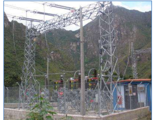
Pórtico Machupicchu II (Proyecto L.T. 220 kV Machupicchu-Abancay-Cotaruse de CTM)
