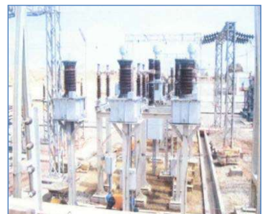
Celda 66 kV S.E. Paramonga Nueva
