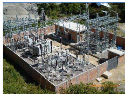
Vista panorámica de la S.E. 8 de Agosto
