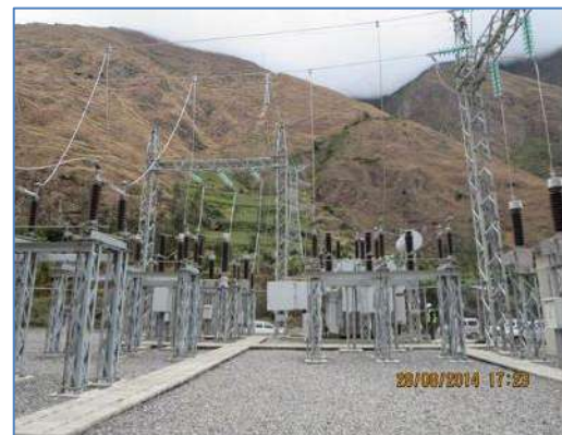
Vista Pórticos S.E. Runatullo III
