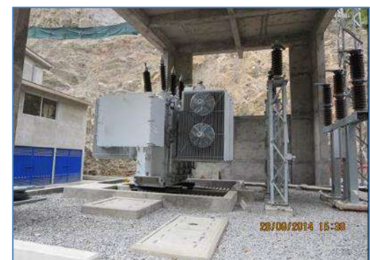
Vista del Transformador
