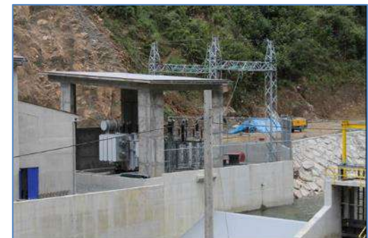
Vista de la S.E. Runatullo II
