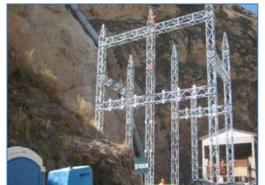
Pórtico de la S.E. Canchayllo
