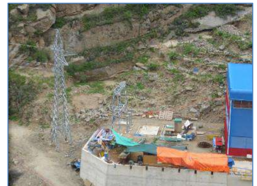
Ubicación de S.E. Chancay y Pórtico de Salida de Línea
