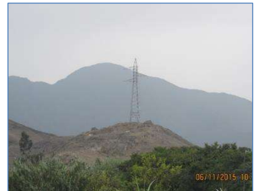
Torre Estructural N° 123 de la Línea de Transmisión 60 kV
